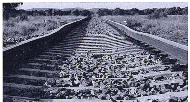
FIGURE 3 – Défaut (important) de nivellement
